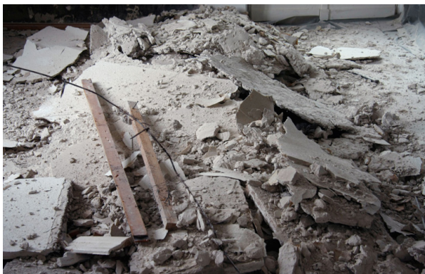
Gipsabfall in Bauschutt
