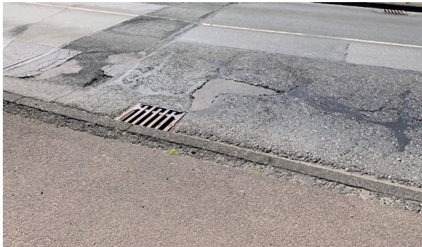
Typische Straßenschäden einer sanierungsbedürftigen Straße
