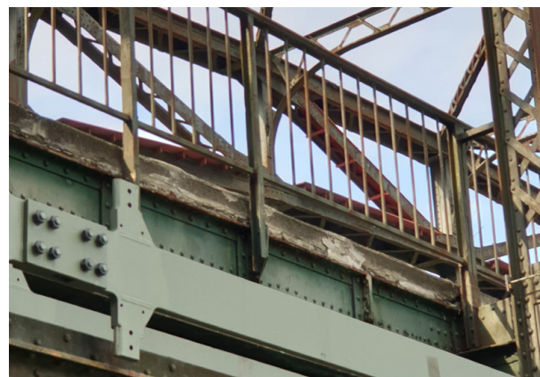
Sanierungsbedürftige, kommunale Brücke
